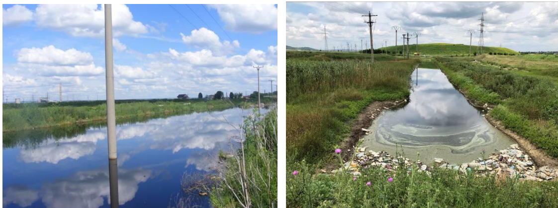
Fig. 4.4. Canalul colector de drenaj, în partea de N, anul 2014 aflat în situație de supraplin (foto stânga), comparativ cu anul 2019 (foto dreapta)
